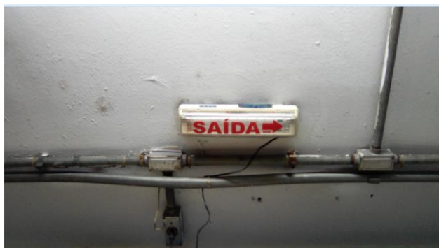
Sinalização de emergência, rota de fuga.
